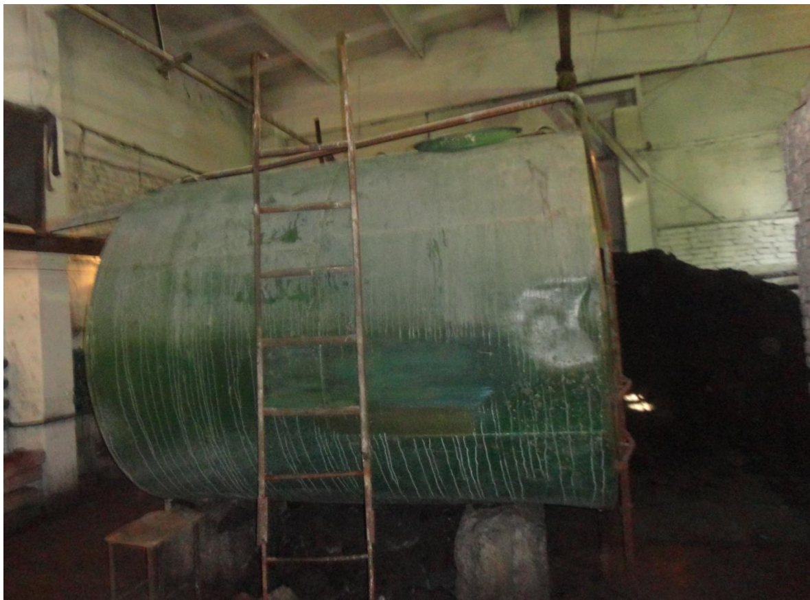
Рисунок 1.7 – Бак запаса подпиточной воды
