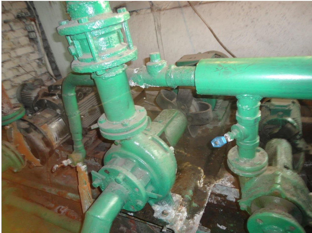
Рисунок 1.4 – Насосы, установленные на котельной с. Зюзя
