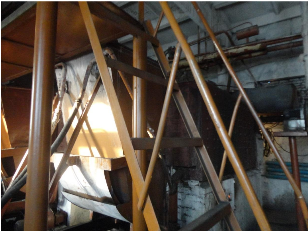
Рисунок 1.2 – Котел КВ-1,0, установленный на котельной с. Зюзя
