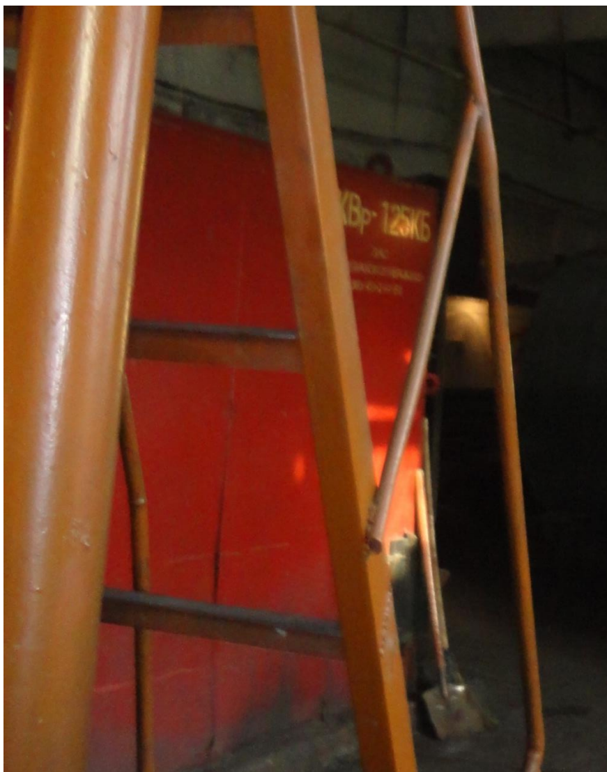
Рисунок 1.3 – Котел КВр-1,25, установленный на котельной с. Зюзя
