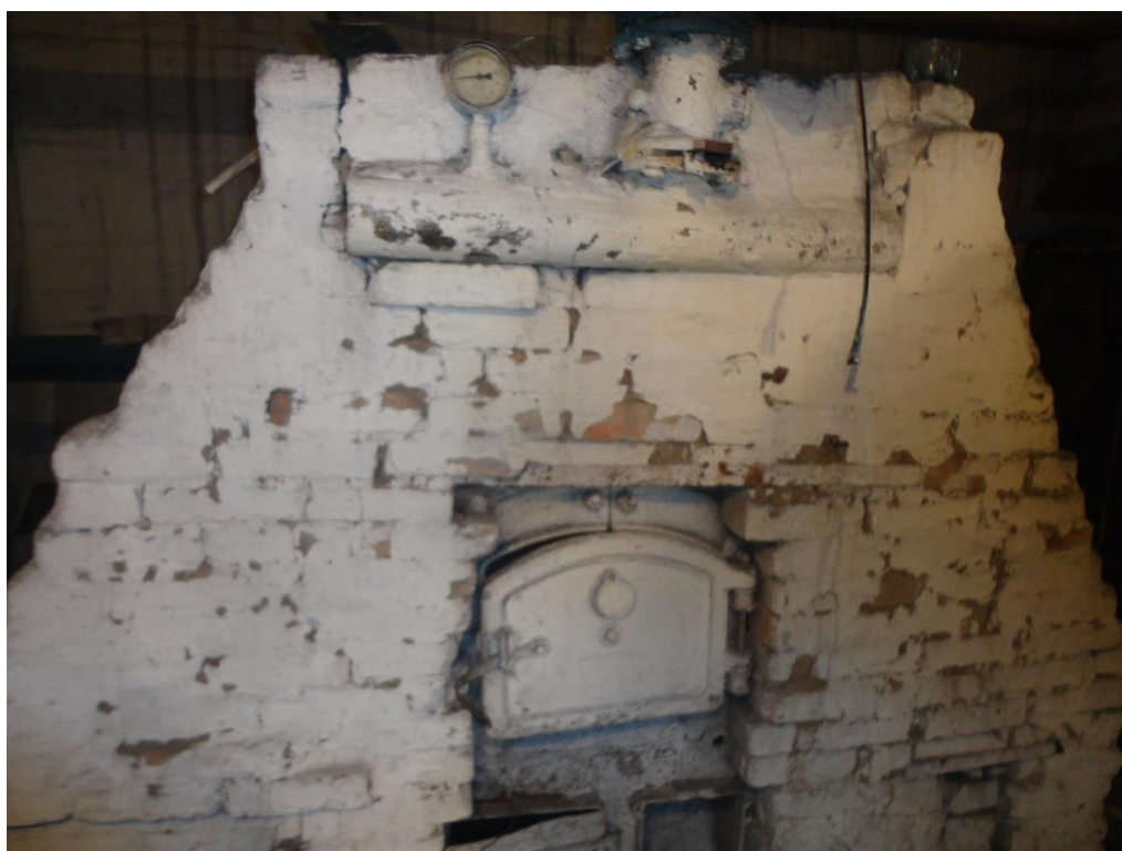
Рисунок 1.3 – Котел индивидуального изготовления, установленные на котельной д. Квашнино
