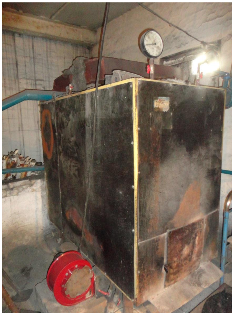
Рисунок 1.2 – Котел КВ-0,3 установленный на котельной д. Квашнино
