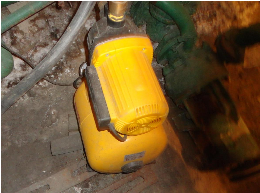
Рисунок 1.5 – Подпиточный насос, установленный на котельной д. Квашнино
