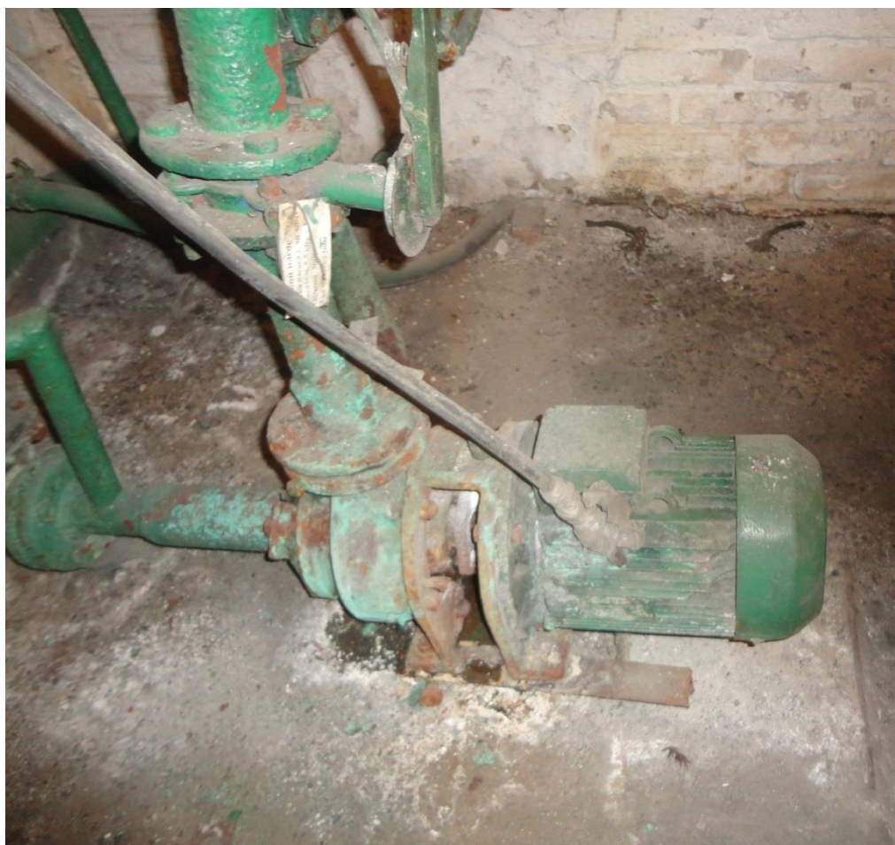
Рисунок 1.4 – Насос сетевой К 45-30, установленный на котельной д. Квашнино
