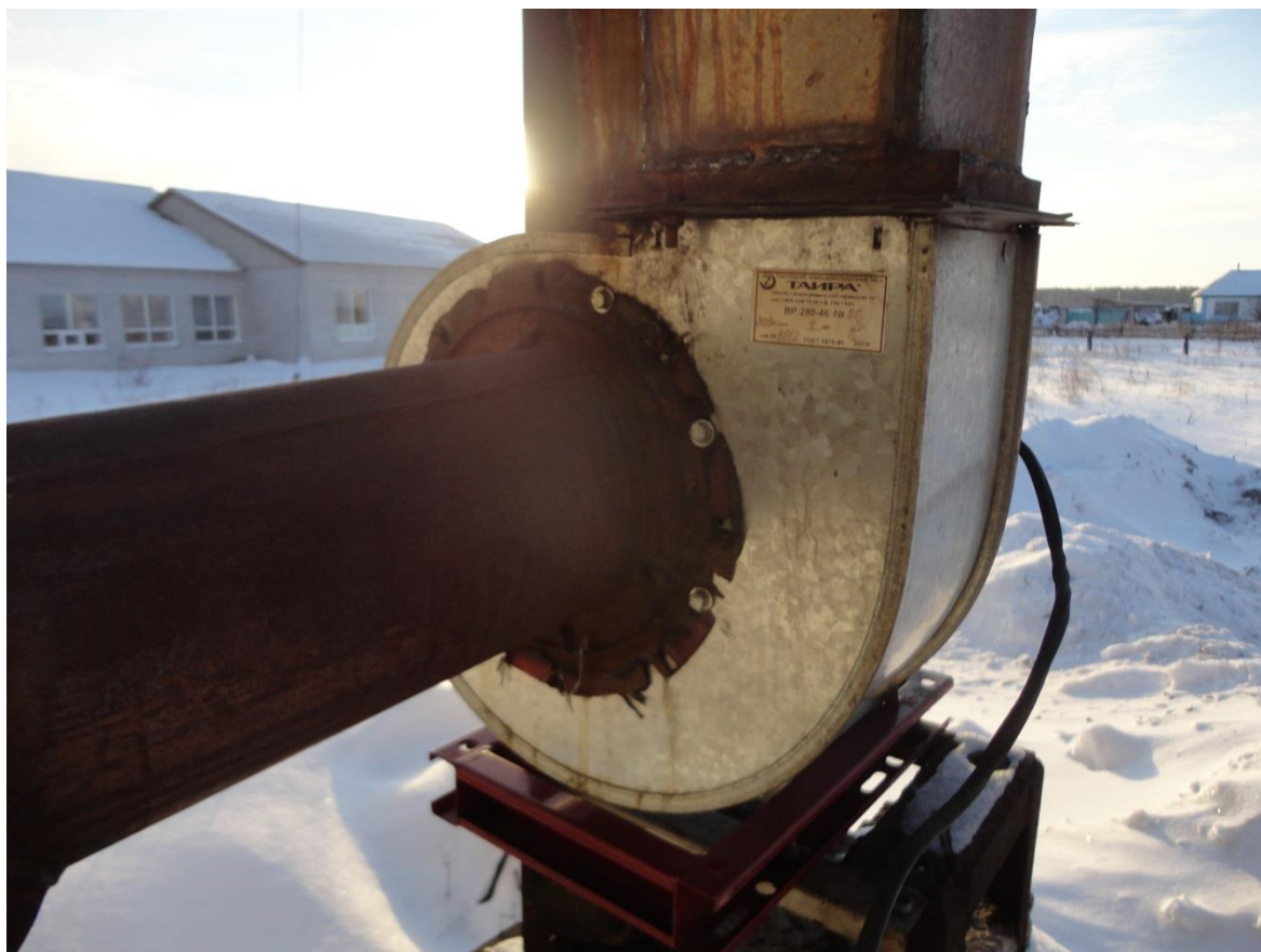
Рисунок 1.7 – Дымосос котельной д. Квашнино
