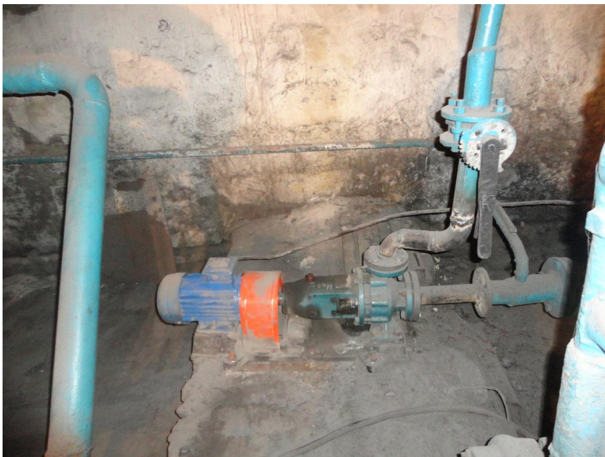
Рисунок 1.2 – Насос сетевой К 50-32-125, установленный на котельной д. Казанцево
