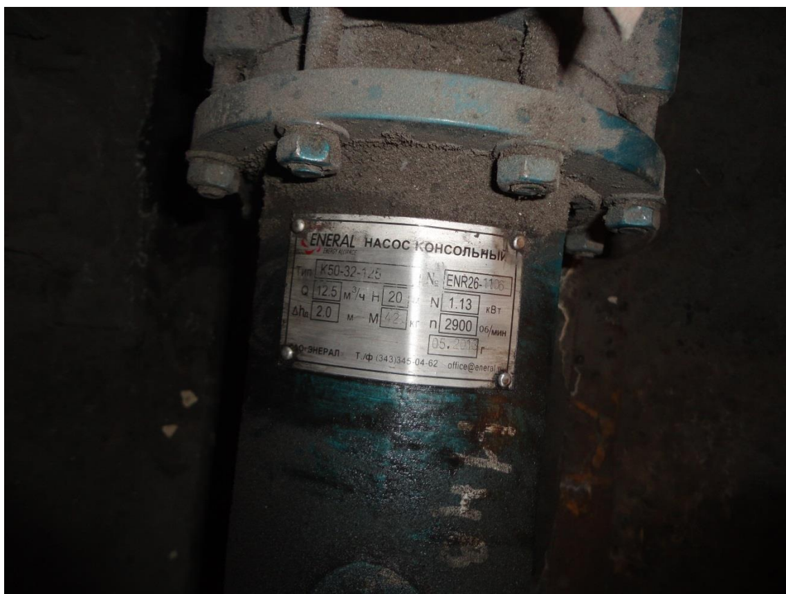
Рисунок 1.3 – Насос сетевой К 50-32-125, установленный на котельной д. Казанцево
