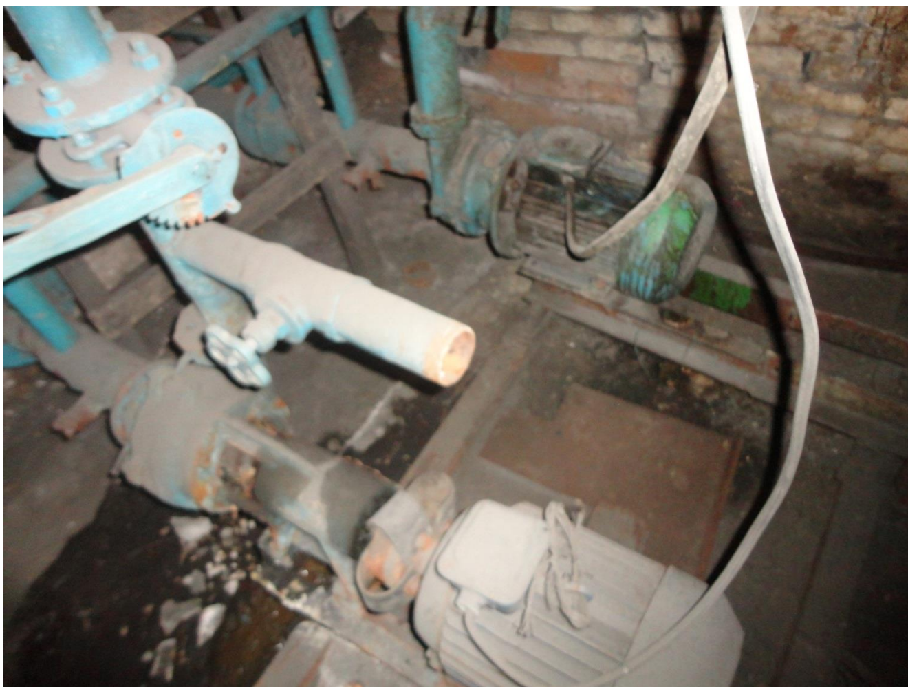
Рисунок 1.3 – Насосное оборудование котельной д. Белово
