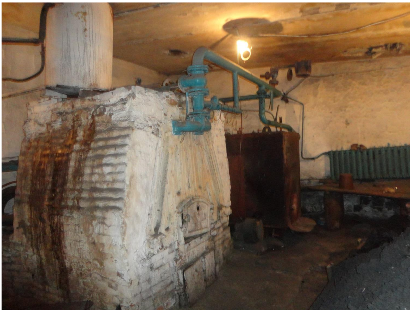
Рисунок 1.2 – Котельное оборудование котельной д. Белово
